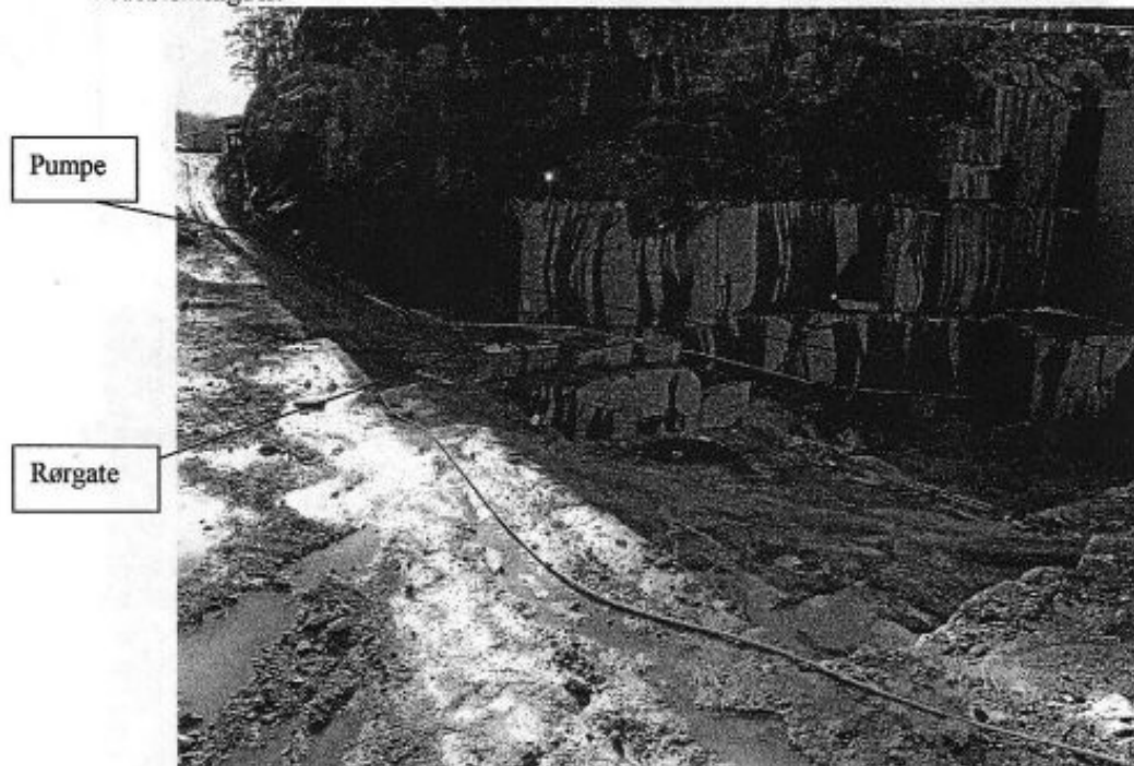
Fig. 1. Pumpestasjon ned i Vardås brudd med tilhørende rørgate.
